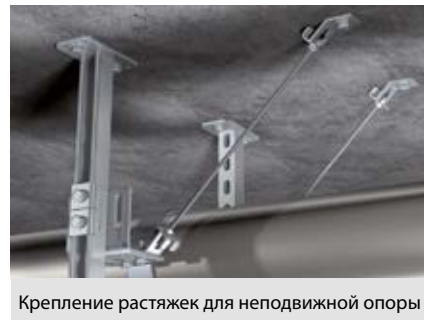
Крепление тяжелого трубопровода с помощью консоли
