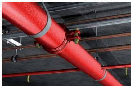
Системы аварийного пожаротушения
